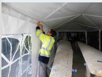
22 décembre : installation de la « cabine de peinture » pour la préparation des ailes du Squalo
